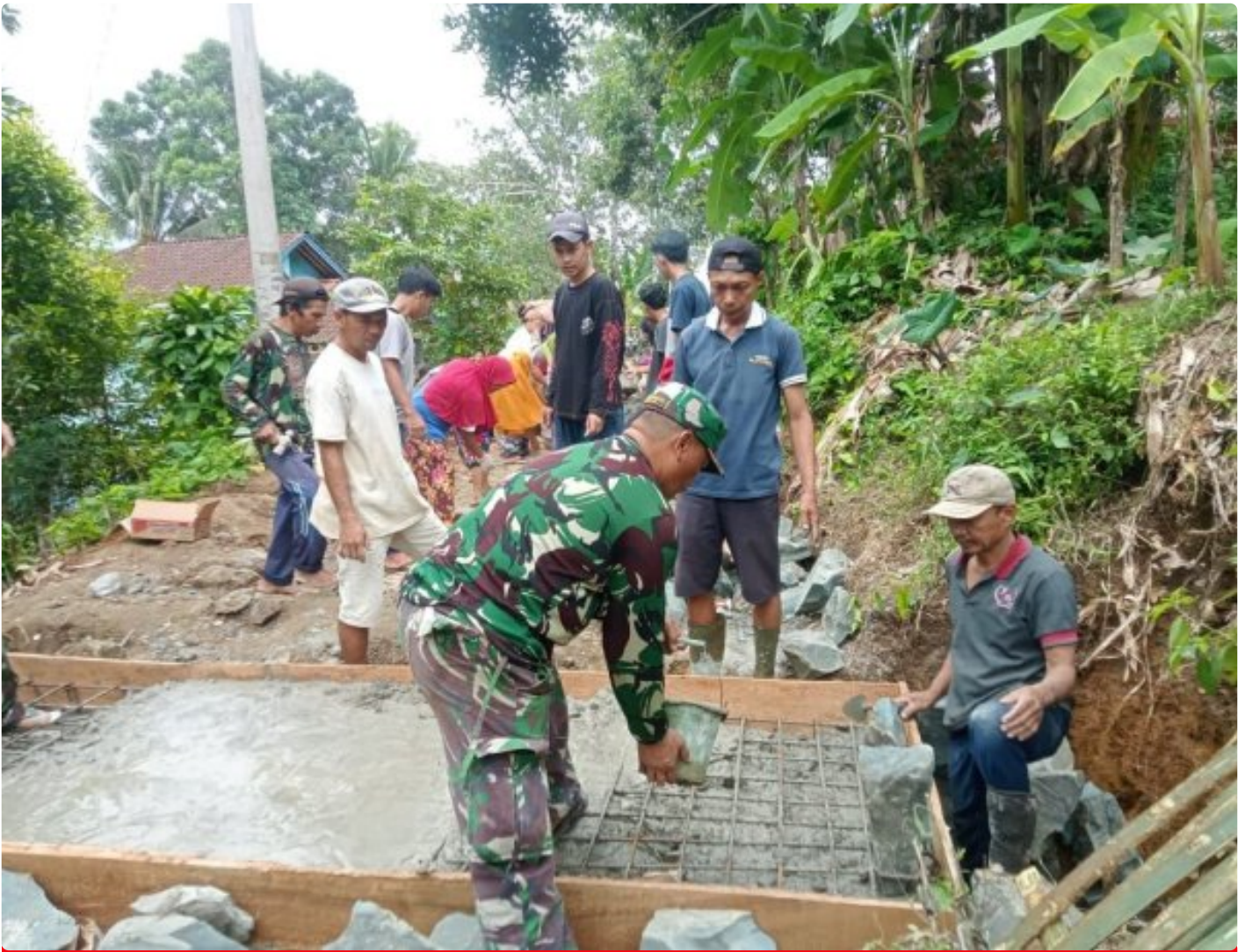
Sertu Nuri spesialis pembuat jembatan plat beton dari koramil 0622-14/Surade dalam TMMD ke 117 KODIM 0622/Kabupaten Sukabumi
